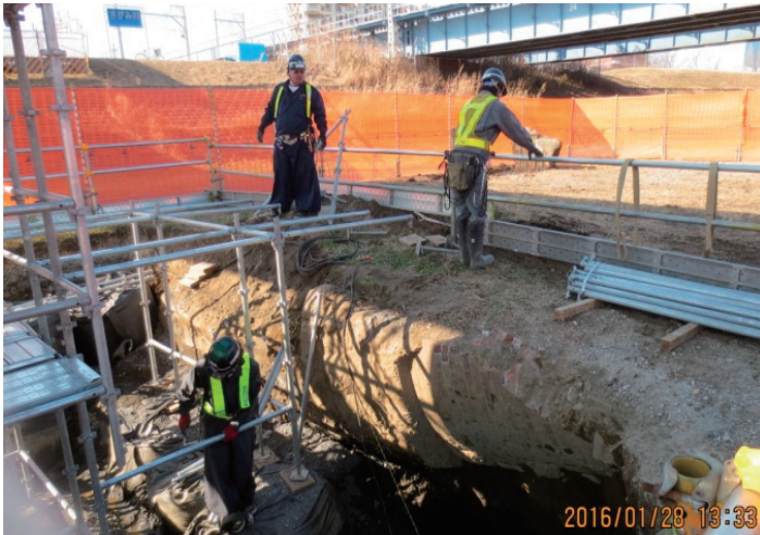
写真30 旧橋脚 P-23 転倒状況
