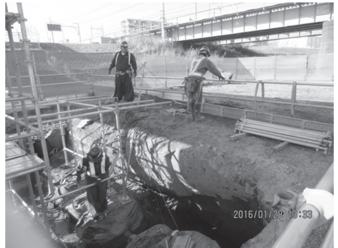
写真 7 旧橋脚 P-23 の転倒状況
