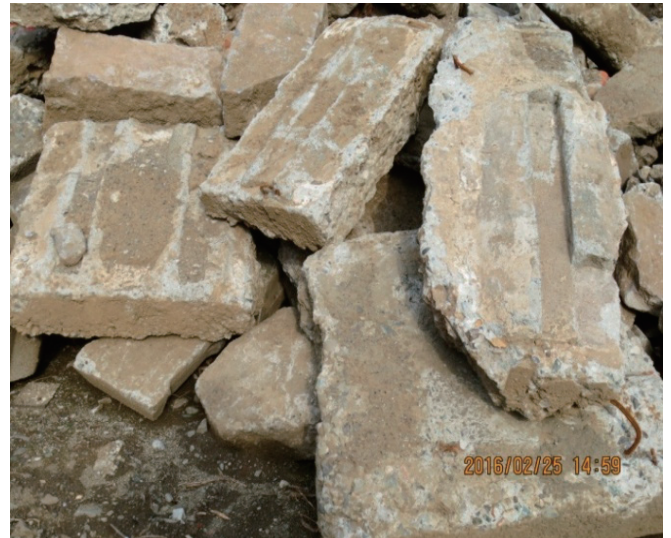
写真 25 旧 P-25 橋脚の瓦礫 (写真 24 拡大)
