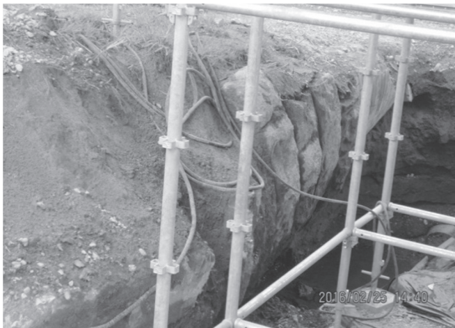
写真 8 旧橋脚 P-23 基礎部位置から倒壊した巻石組を見る
