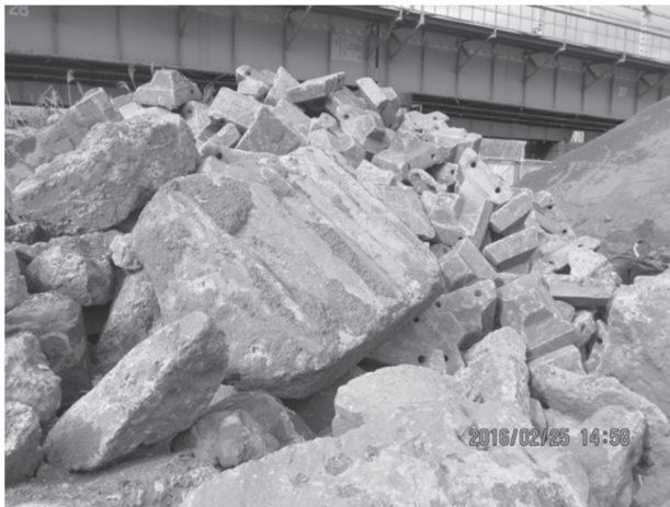
写真2 旧P-25橋脚の瓦礫 （コンクリート塊（ブロック、片））
